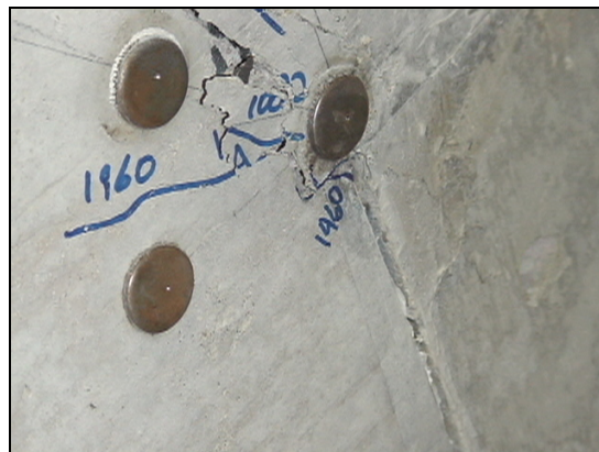
Figura 6.2 – Início do esmagamento do concreto junto à estaca.
