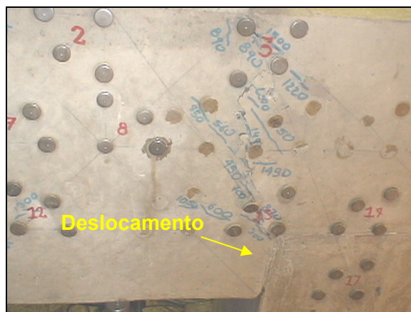
Figura 7.3 – Deslocamento horizontal entre a face do bloco e a face da estaca.
