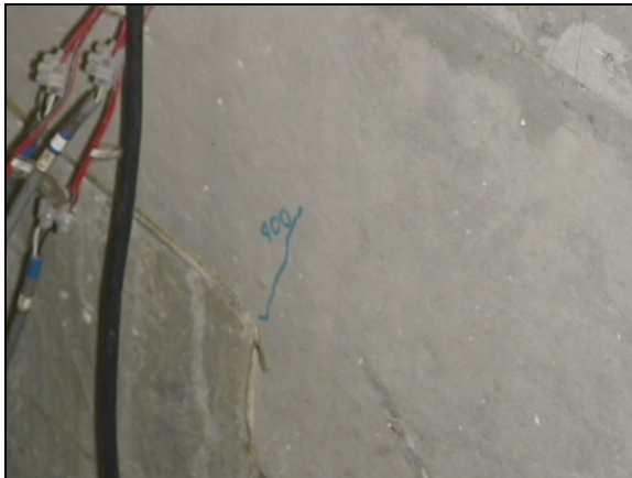
Figura 5.23 – Posição da primeira fissura, junto a estaca.
